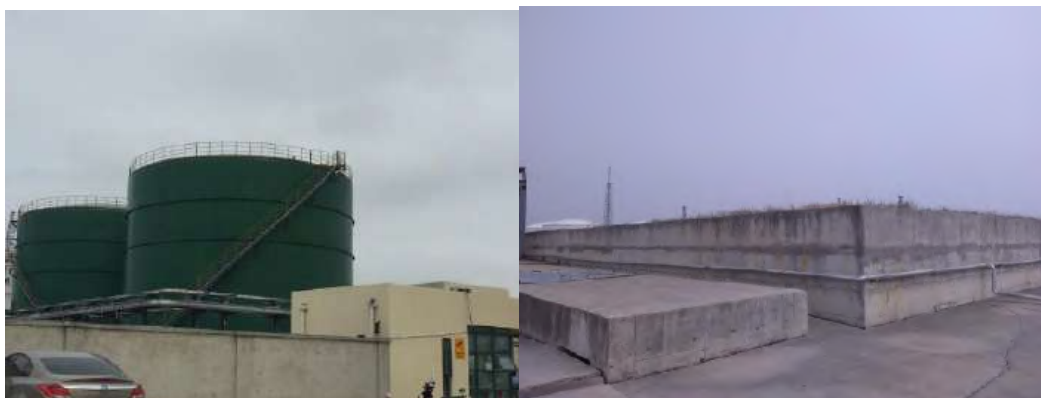
图 2.2-4 依托罐区及消防水罐
